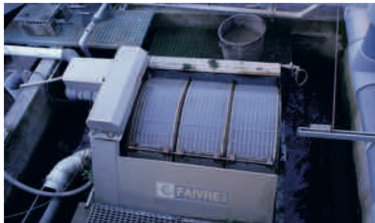
At l'Esturgionnière, top : Biological filter tanks Above : mechanical filter
